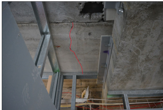
Kaikoura EQ damage
